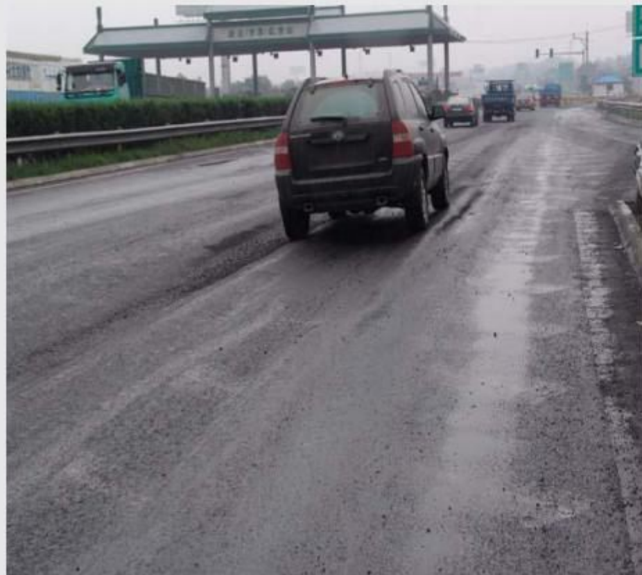
大修前路面损坏
