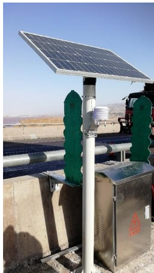
乌海黄河大桥 路面结构温度场采集系统 (含环境温度)
